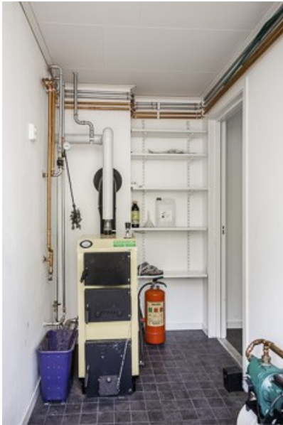
Holzvergaser für die Zentralheizung
