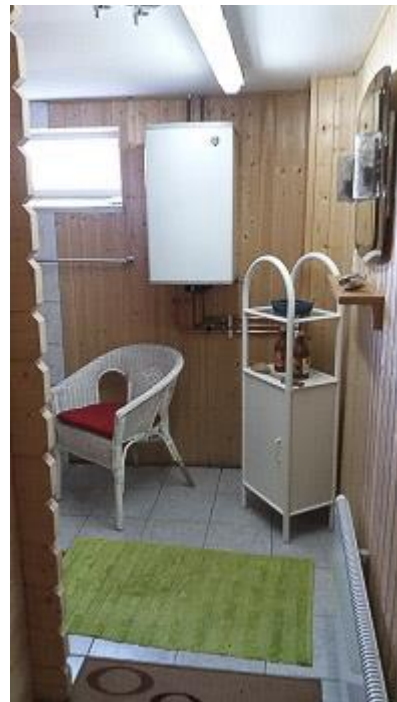
Dusche und Sauna im KG
