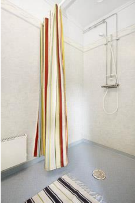
eine von zwei Duschen
